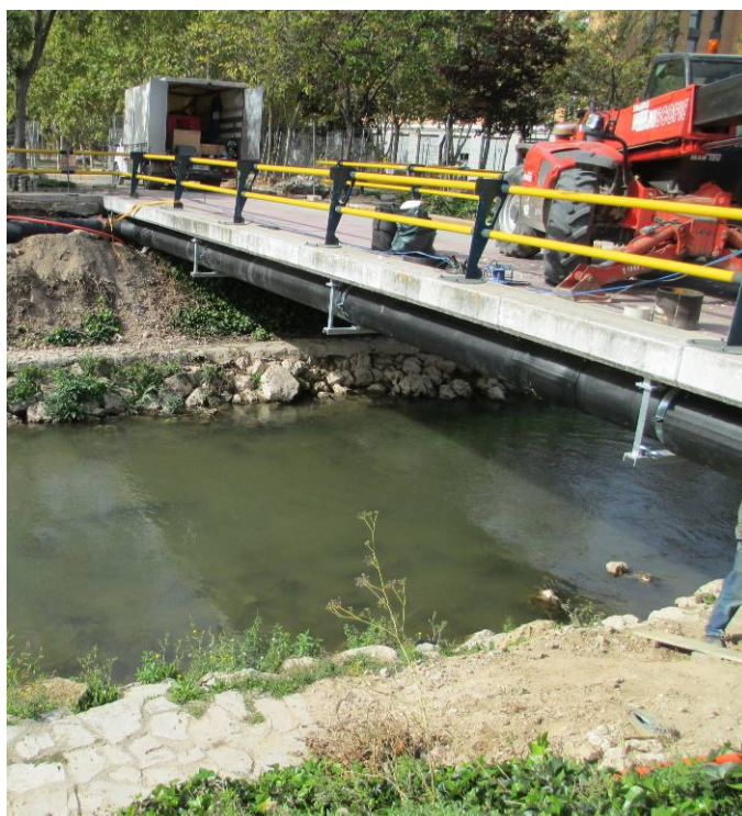
Imagen 14.- Red de distribución aérea por puente.
