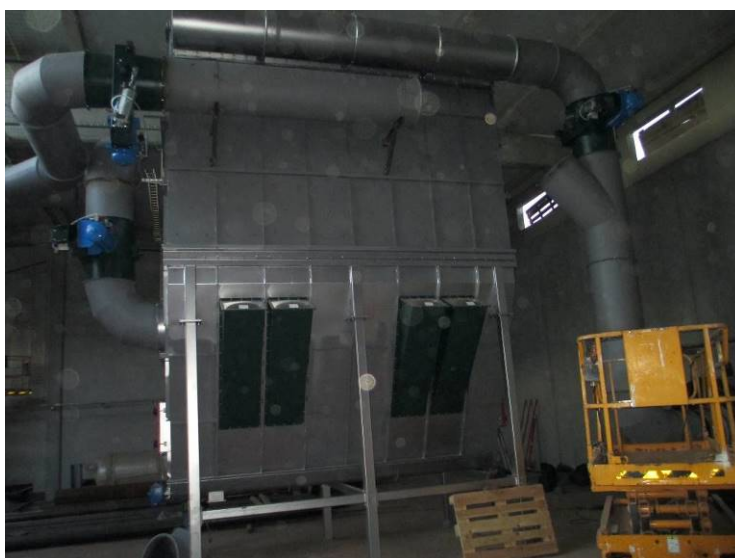
Imagen 9.- Filtro de mangas para una de las calderas.
