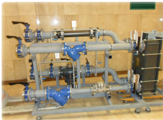
Imagen 19.- Subestación de intercambio de una da las salas.
