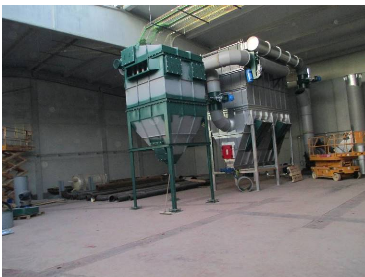
Imagen 10.- Filtro de mangas y ciclón que se instalará para cada caldera.
