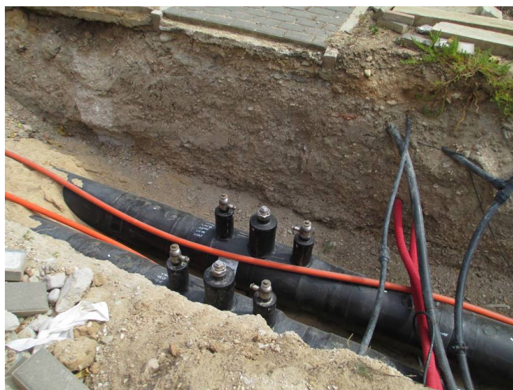
Imagen 18.- Puntos de control. Válvula de corte + Drenaje/Venteo.
